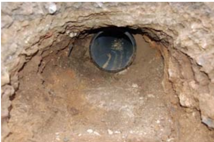
Figur 17. En stor sten påträffad mitt i Bygatan på ca 1,10 meters djup. På fotot ligger stenen strax framför den genom vägen dragna fjärrvärmeledningen. Foto från öster. Foto: Lars Jönsson, Malmö Museer.
