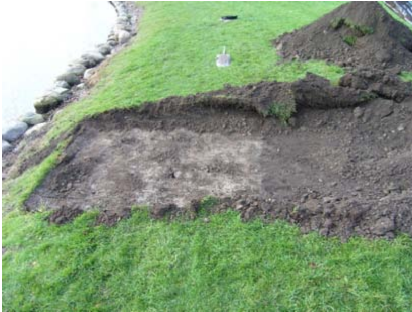
Fig. 14. Massorna som påförts närmast bakom vallgravskanten var stabila både i provschakt P1 och P2 . De utgjordes i huvudsak av lera eller jord med hög inblandning av lera. Här visas schakt P2 där lerlagret nådde 3,90 m ut från vallgravskanten. Vid det andra schaktet P1 iaktogs det att det till och med låg vidjor i massorna närmast vallgravskanten. Det är dock osäkert om dessa lagts dit avsiktligt för att armera och stabilisera eller om de bara råkat följa med vid uppfyllningen bakom vallgravskanten.
