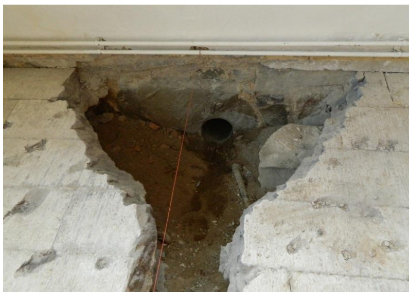
Fig. 3. I rummet i kyrkans nordöstra hörn togs delar av golvet upp, och ett hål borrades genom kyrkans grundmur.
