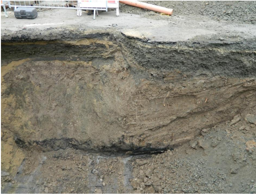
Fig. 4. Den västra sidan av det södra kabelbrunnsschaktet efter att delar av schaktväggen rasat. I schaktets nedre del kan det svarta humösa lagret och det underliggande lerlagret anas.
