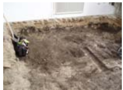
Foto 3: Avschaktat golv i tornrummet.
