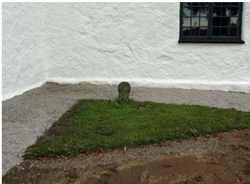
Figur 5. Genom att schaktet för dagvattenledningarna drogs vinkelrät mellan sidoskepp och kor, respektive kor och torn, undveks att äldre gravstenar och gravhällar i kyrkans absoluta närhet påverkades av markarbetena.
