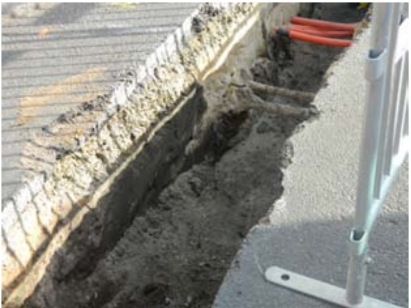
Fig. 4. Där den östra delen av fjärrvärmeschaktet svängde in mot vodkafabrikens bakre entré fångades en rest av ett kulturlager i schaktväggen. Foto av Nils Johansson från söder.
