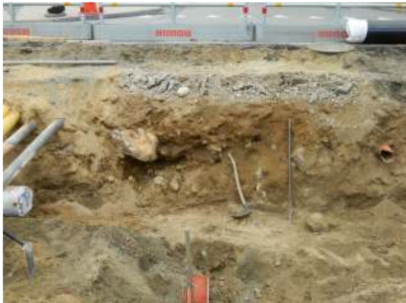
Fig. 11. Bastionen Sjællands norra murarm (800) stack ut ur den östra schaktväggen, men hade delvis skadats vid nedläggandet av en gasledning under 1930-talet. Foto Tony Björk från väster.
